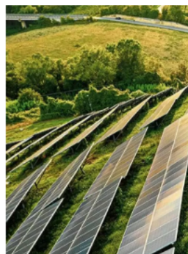
Paneles solares. EVE
