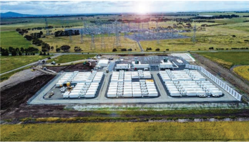
Imagen 2.– Planta de baterías, Queensland
